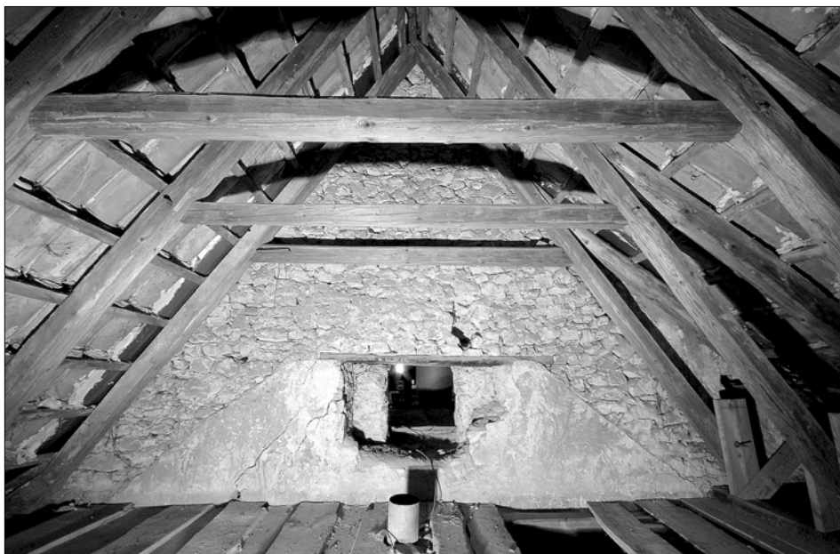
Obr. 10: Praha - Podolí, kostel sv. Michaela archanděla, pohled na východní líc štítu lodi nad triumfálním obloukem z prostoru krovu presbytáře. Na lomovém zdivu štítu je patrné lichoběžníkové pole omítky s nástěnnou malbou (foto J. Veselý, 2006).
